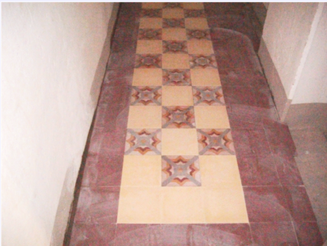
pavimentazione realizzata con elementi di recupero provenienti da smontaggi di cantiere loc T40
