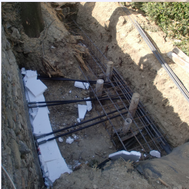
collegamento cordolo e muro esterno con barre Dywidag dettaglio delle barre inguainate
