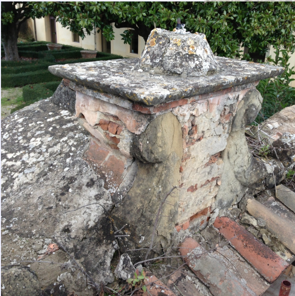
stato di fatto dell'elemento sommitale incollaggio delle scaglie di elementi in pietra arenaria
