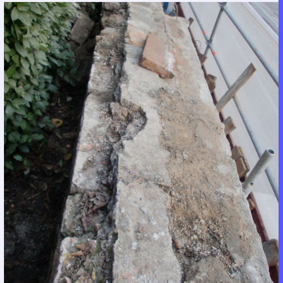
la faticenza del coronamento dopo la rimozione del manto
