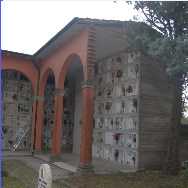
porticato destro prima dell'intervento sono ben visibili i dissesti e le lesioni
