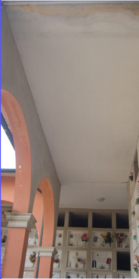
dettagli del porticato destro prima dell'intervento dove sono ben visibili le lesioni provocate dal sisma
