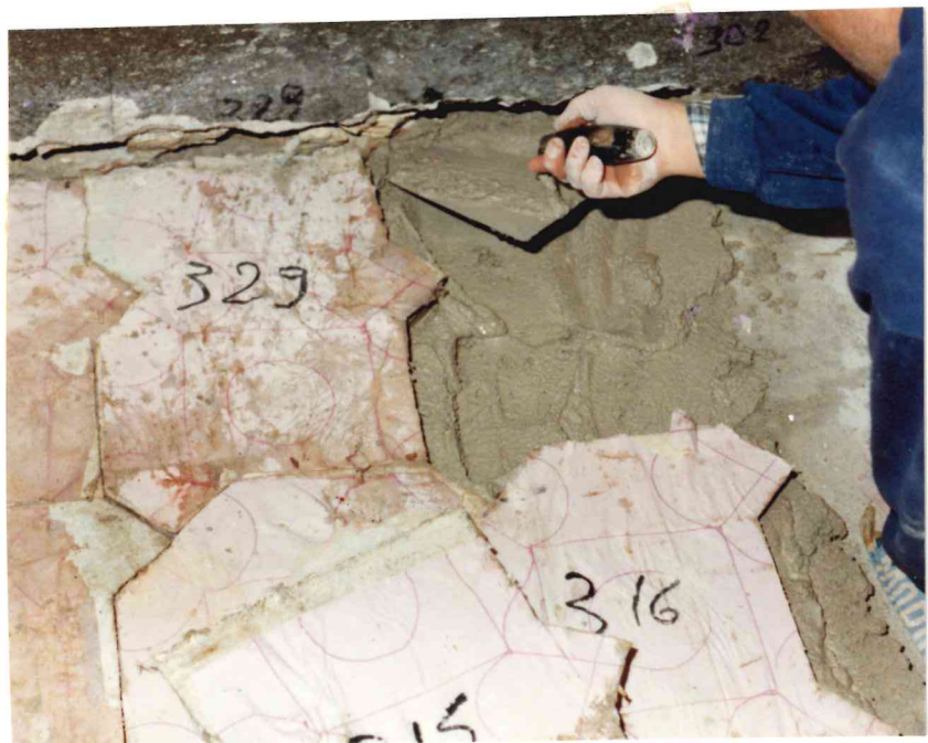
Particolare del rimontaggio importante notare la cura con cui le maestranze ricollocano il pavimento
