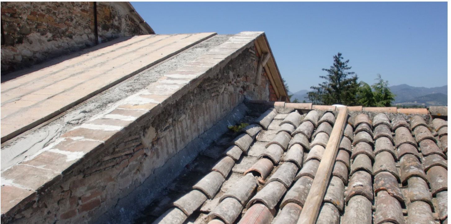
montaggio dello sporto di gronda in pianelle e preparazione per il getto in calcestruzzo
