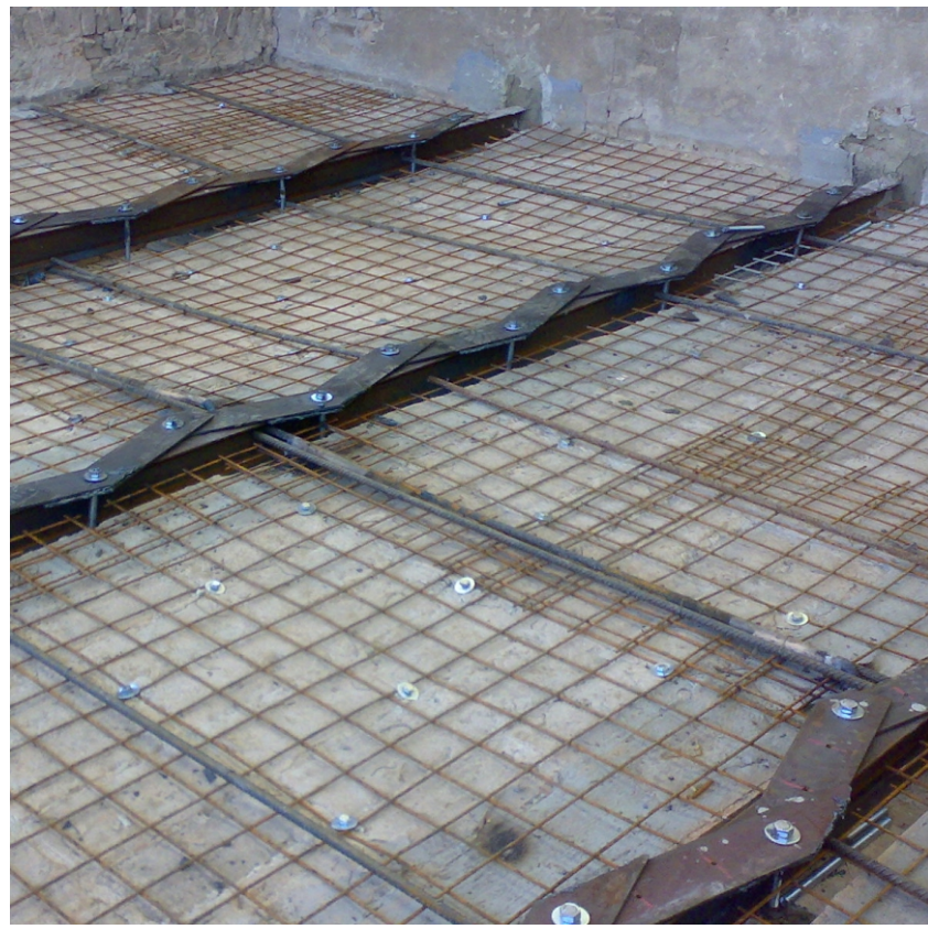
Il confinamento della trave è garantito dal getto finale in calcestruzzo. Lo spessore del calcestruzzo è di 5 cm la restante parte della trave viene inglobata nel massetto del pavimento. Questo per ridurre i carichi ed i spessori
